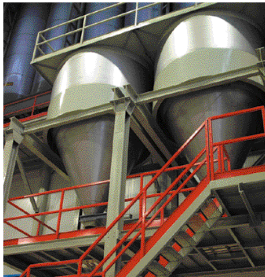
Figura 5 - Silos contenenti atomizzato
