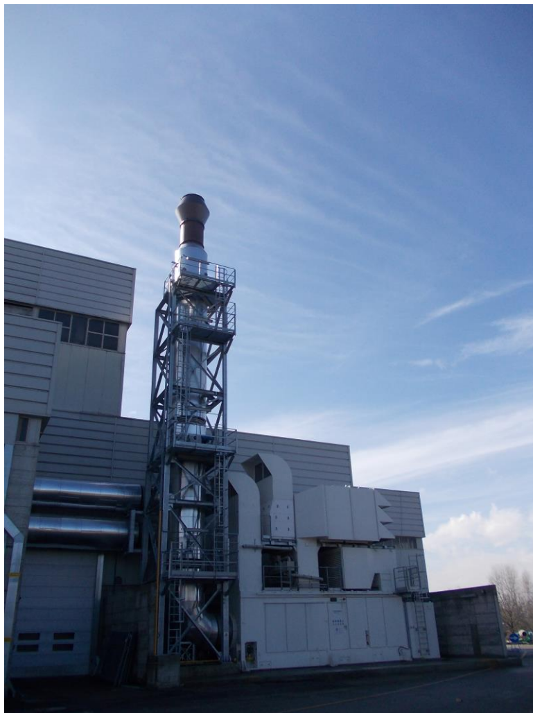
Figura 27 - Impianto di cogenerazione da 4 MW nello stabilimento Padana
