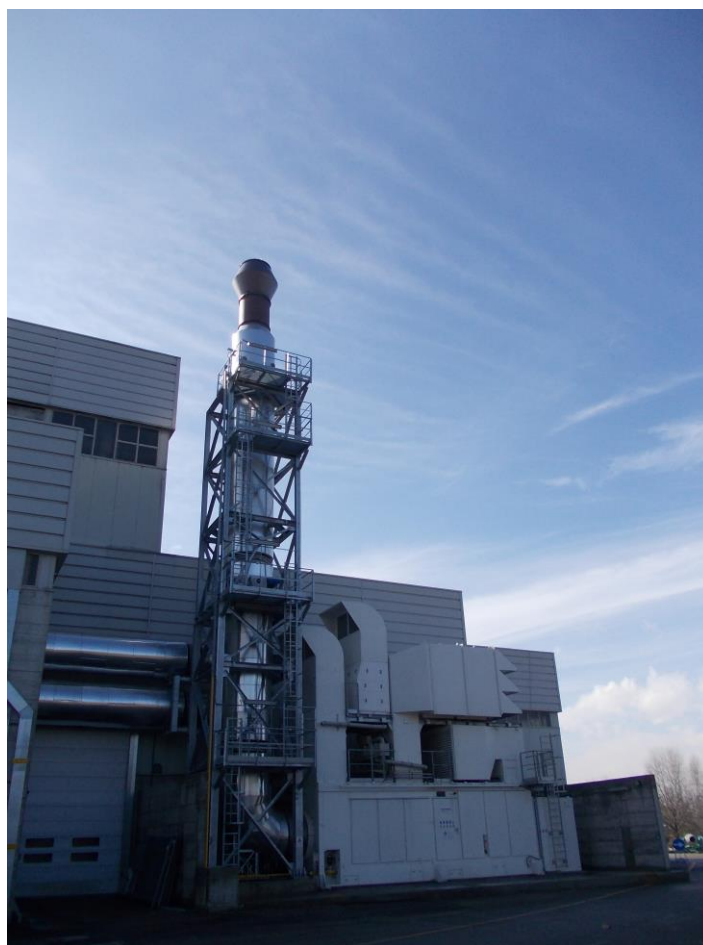
Figura 33 - Impianto di cogenerazione da 4 MW nello stabilimento Padana
