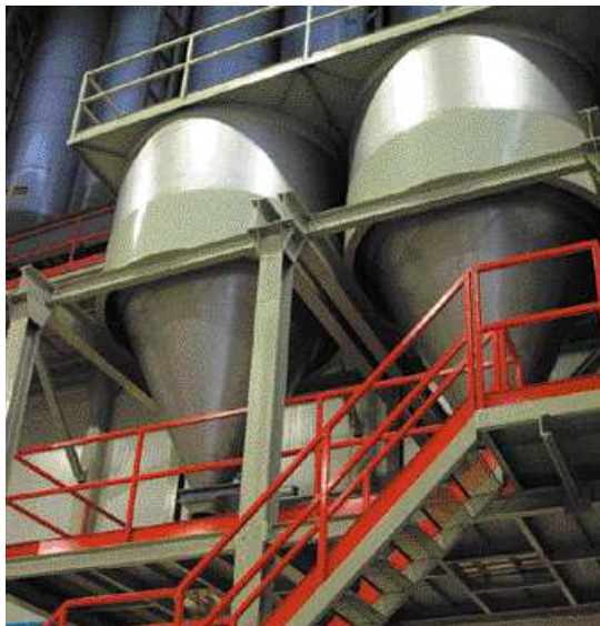
Figura 5 - Silos contenenti atomizzato
