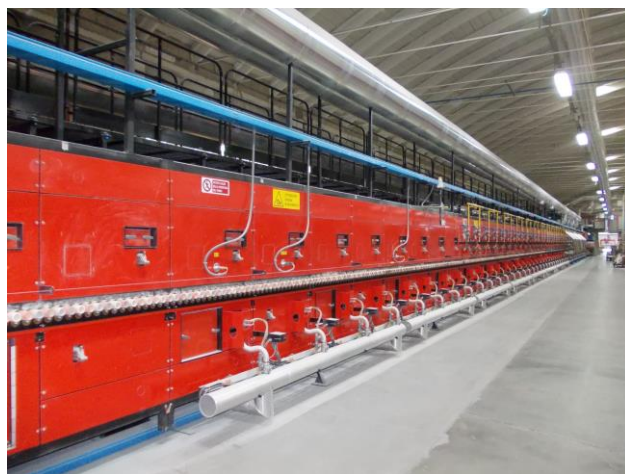
Figura 7 - Forni di cottura delle piastrelle
