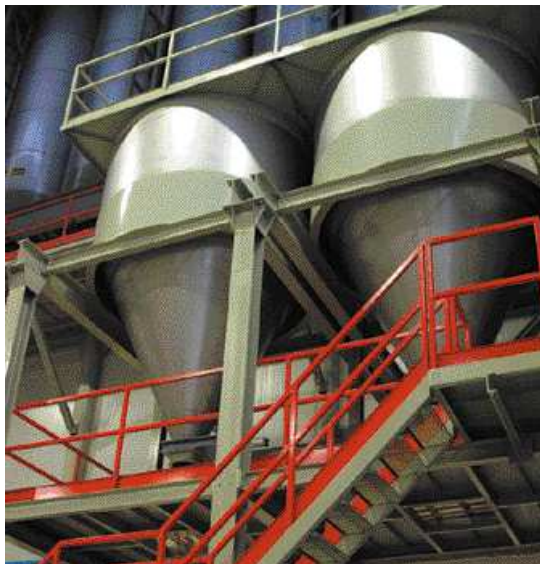
Figura 5 - Silos contenenti atomizzato
