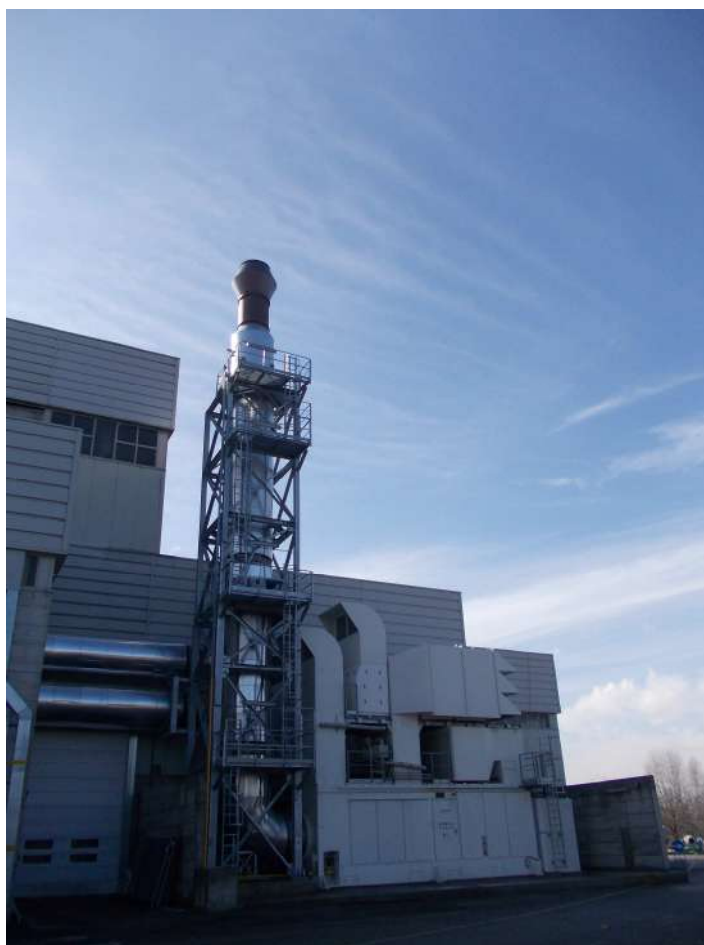
Figura 37 - Impianto di cogenerazione da 4 MW nello stabilimento Padana
